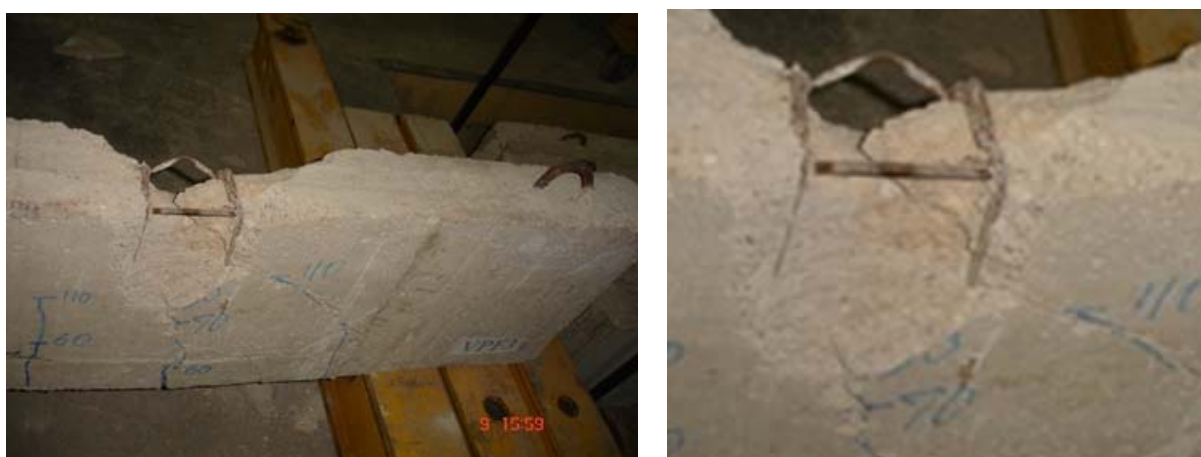
Figura 4.45 – Detalhes das camadas de concreto fissuradas nas mesmas seções VPF3
