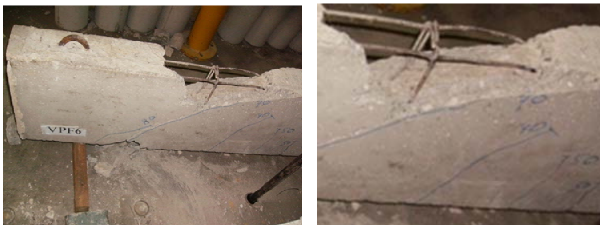
Figura 4.44 – Detalhes das camadas de concreto fissuradas na mesma seção VPF6
